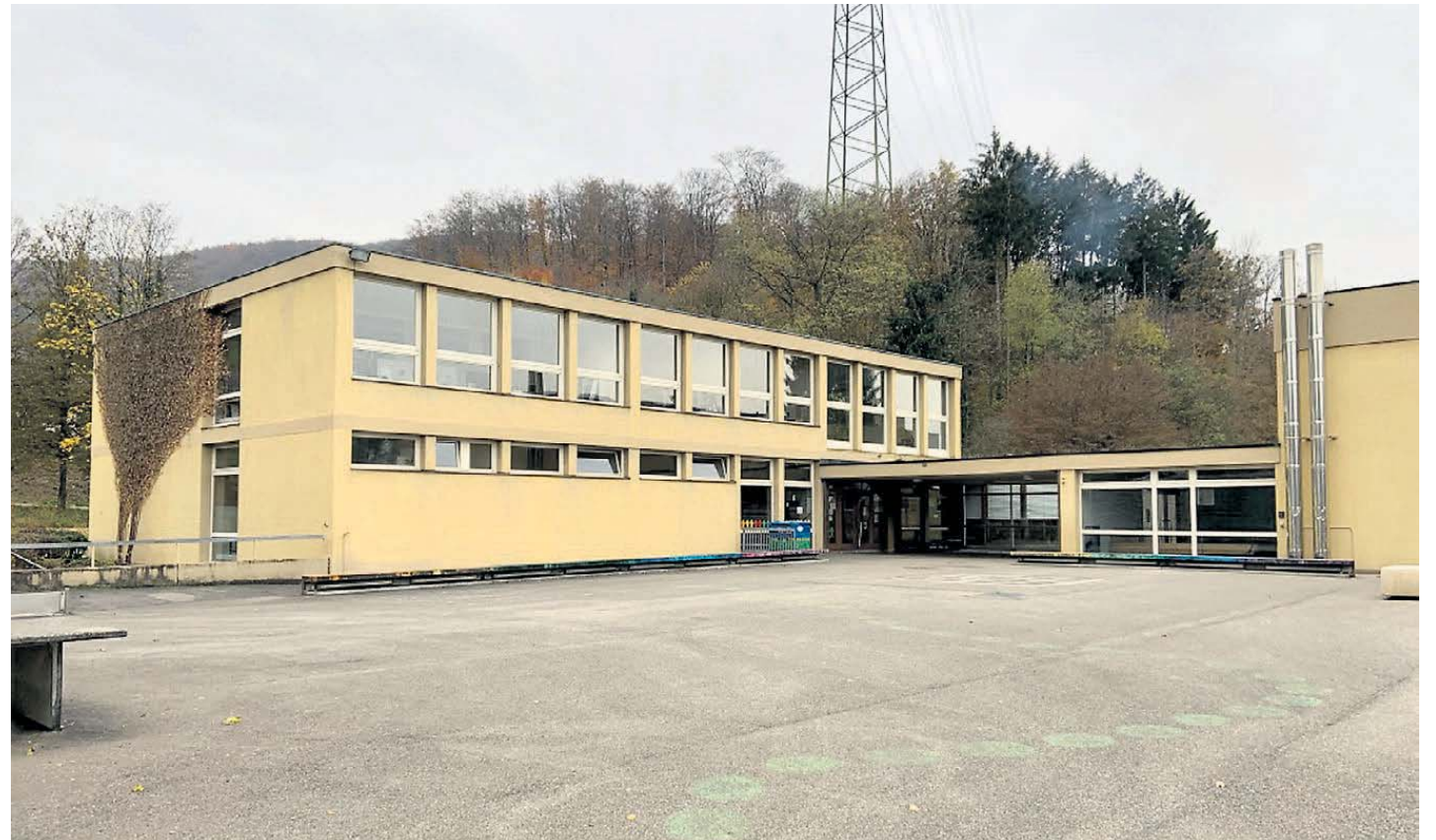
Inzwischen ist im Kapf-Primarschulhaus in Mumpf das Dach undicht geworden und die Treppen und andere sicherheitsrelevante Dinge müssen dringend saniert werden.
